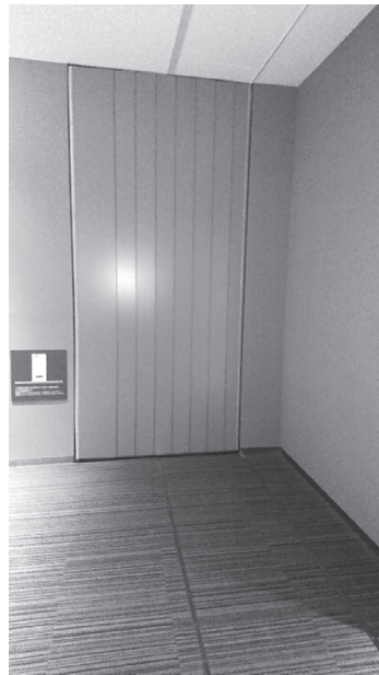
写真13 南館 (左側) と本館 (右側) をつなぐ廊下の壁床の免震エキスパンションジョイント
