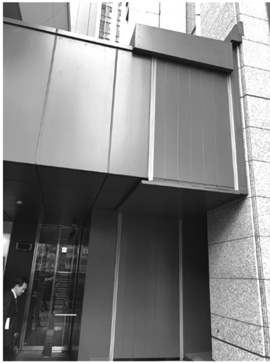
写真16 本館（右側）と南館（左側）をつなぐ渡り廊下の免震エキスパンションジョイント
