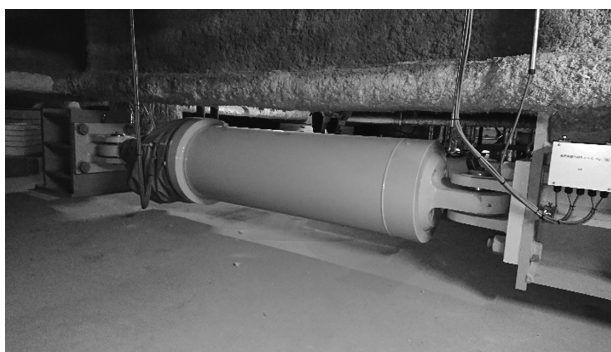
写真7 ロック機構付オイルダンパー（本館免震層）
