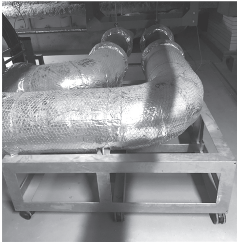
写真10 設備配管のキャスター型免震継手 (本館免震層)
