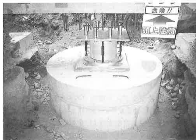
写真-4 免震部材をターンバックル付きボルトで緊張した状態
