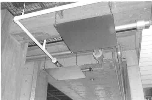
写真-9 天井に設置された設備配管
