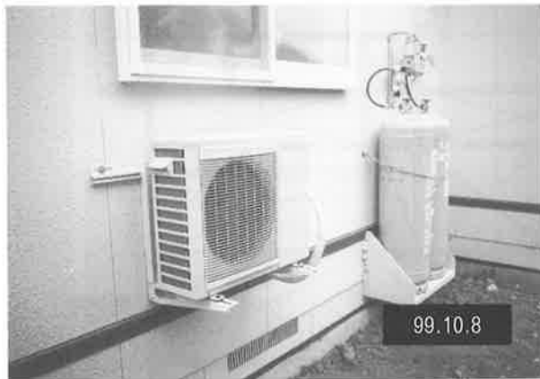
写真-5 エアコン室外機・プロパンガスボンベ設置状況
