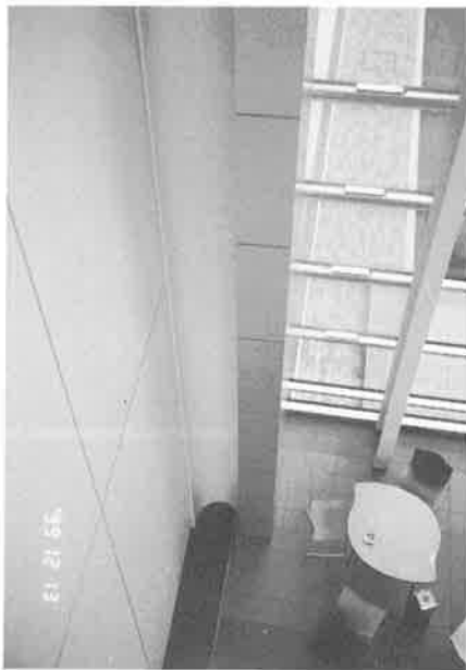
写真-7 外壁面のエキスパンション
