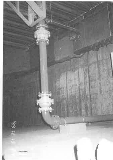
写真-10 免震用配管SHIPシステム
