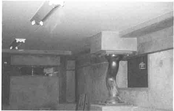
写真-2 地下1階の免震層
