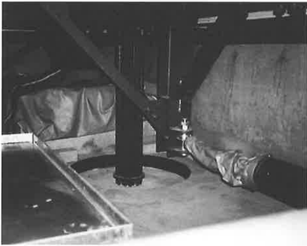
写真-4 変位抑制装置とオイルダンパー
