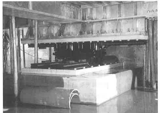
写真4 直動転がり支承
