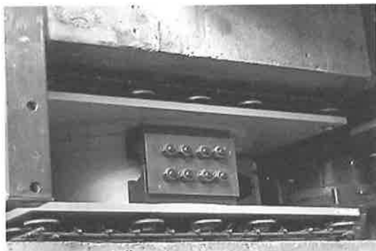
写真-11 耐震プレート
