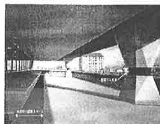
図-11 免震層外部
