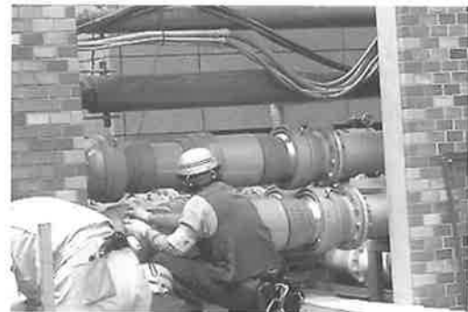
写真-9 免震対応設備配管
