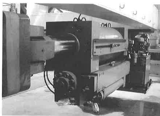
図-12 多機能ダンパーの取付状況
