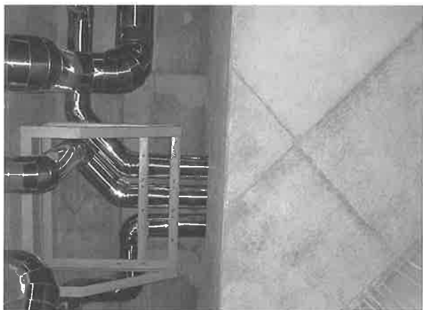
写真-5 配管の様子（上向き）
