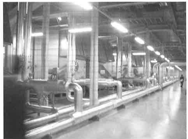
写真-4 空調機械室
