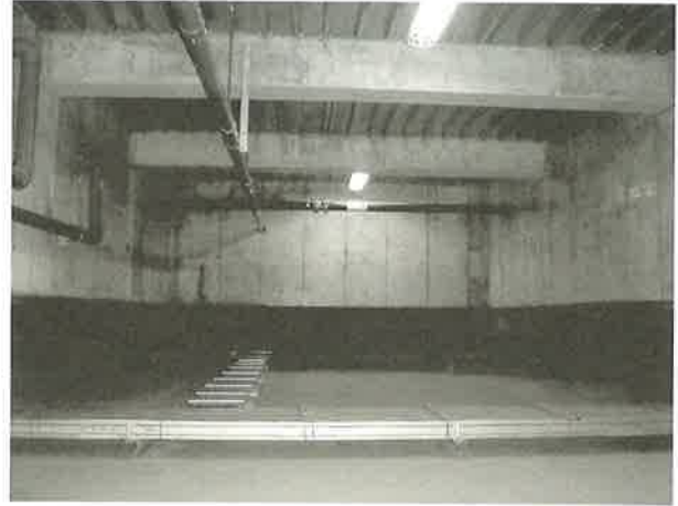
写真-11 免震ピット
