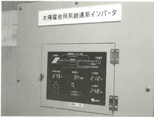
写真-8 太陽光発電状況
