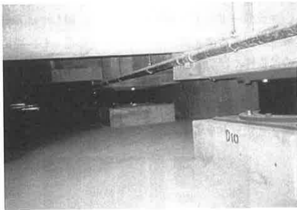
写真5 免震層の鉛プラグ入り積層ゴム支承
