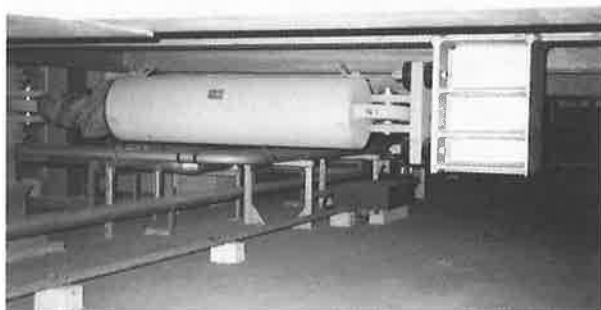
写真-2 オイルダンパー
