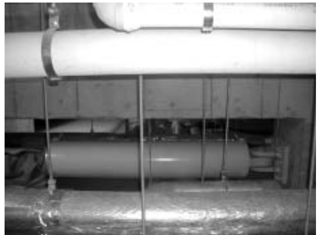
写真-9 オイルダンパーの設置状況
