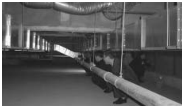
写真4 免震層内見学中
