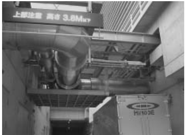
写真11 フレキシブル設備ダクト
