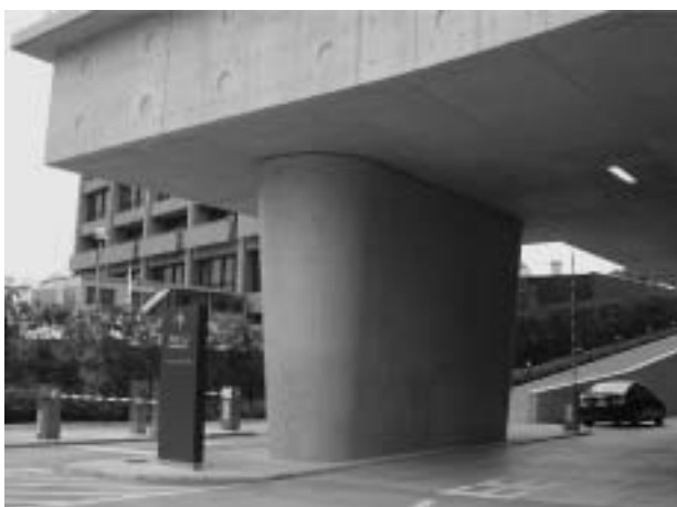
写真2 柱頭免震の柱
