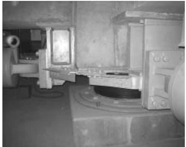
写真5 オイルダンパー取付部
