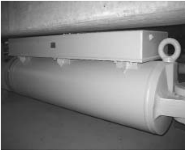
写真3 オイルダンパー
