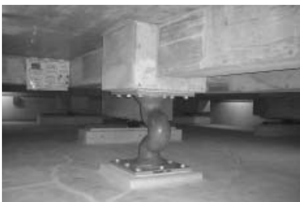
写真5 鉛ダンパー(1基)
