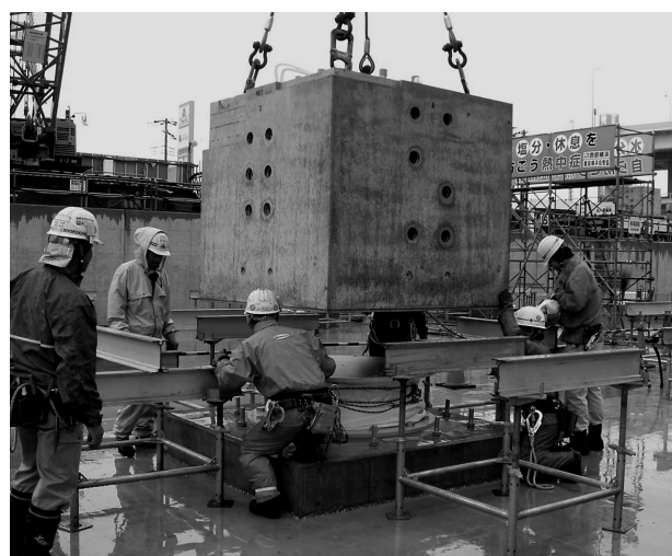
写真3 免震材料とPCaフーチング
