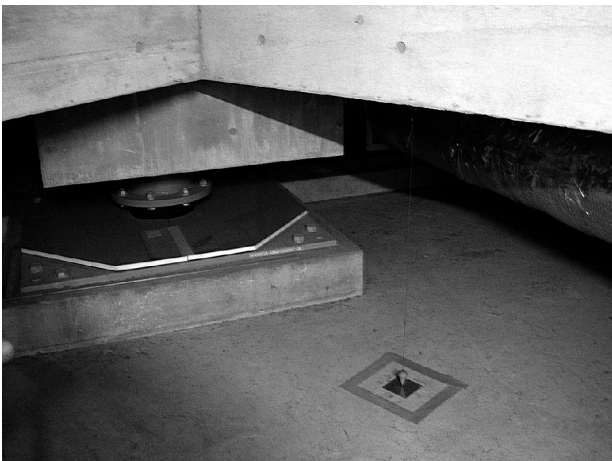
写真9 低摩擦すべり支承と下げ振り
