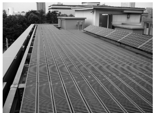
写真11 屋上の積雪荷重を受ける架台
