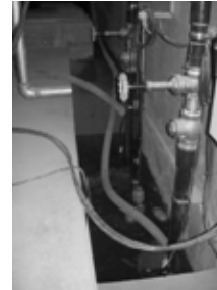
a. 釜場と排水設備
