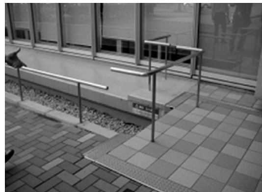
写真3 地盤改良境界部の周辺の手すりの沈下
