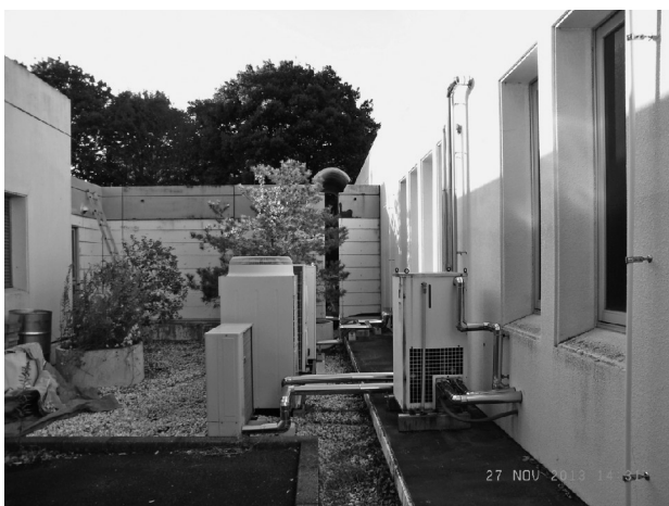
写真13 建物外周部の空調室外機の設置状況
