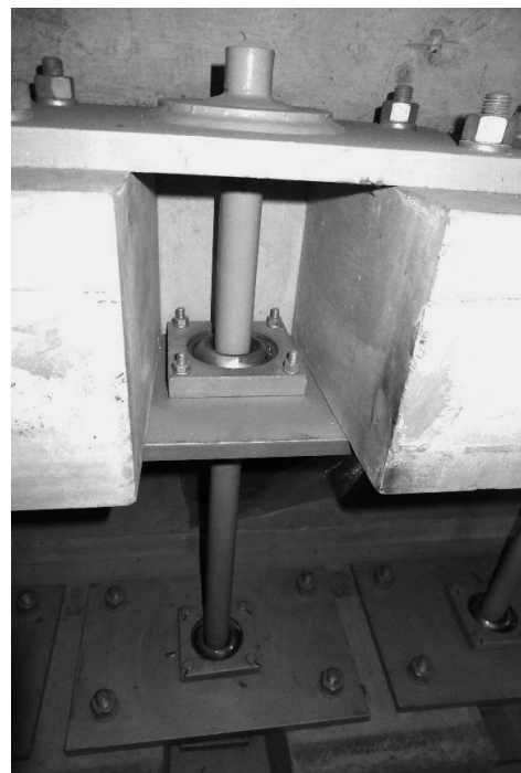
写真10 鋼棒ダンパーの取付部
