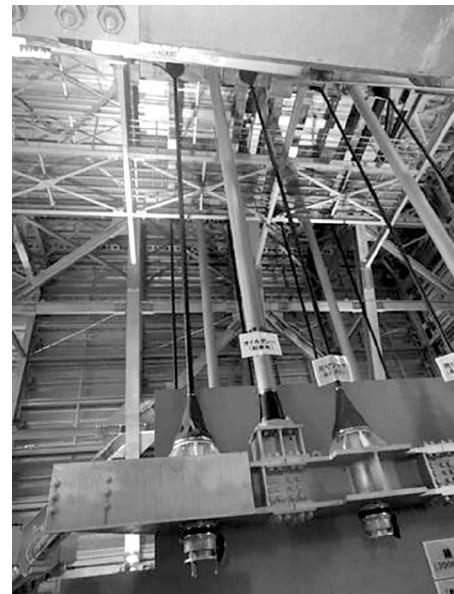
写真2 長さ8mの構造用吊ワイヤーケーブル
