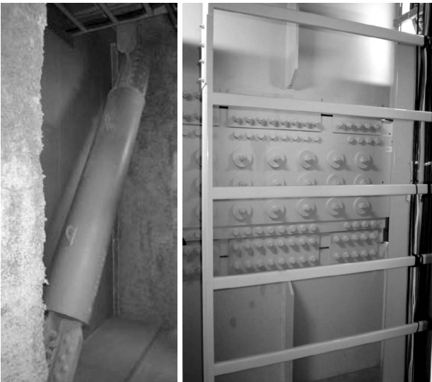
写真3 制震ダンパー (左：座屈拘束ブレース 右：摩擦壁ダンパー)
