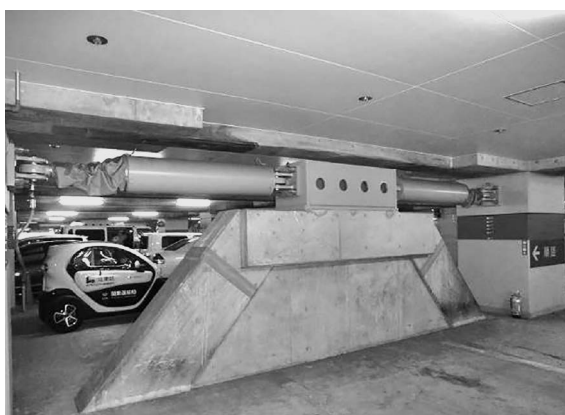
写真5 オイルダンパーの設置状況
