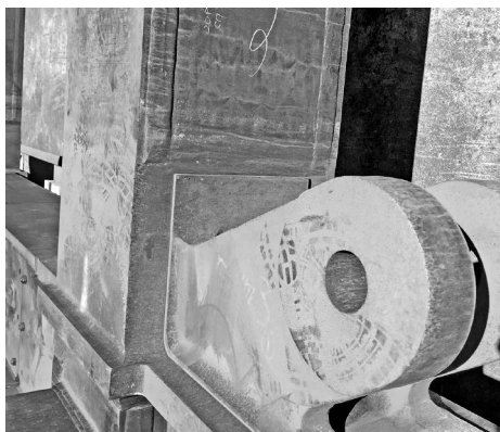
写真5 束柱と仕口の溶接部
