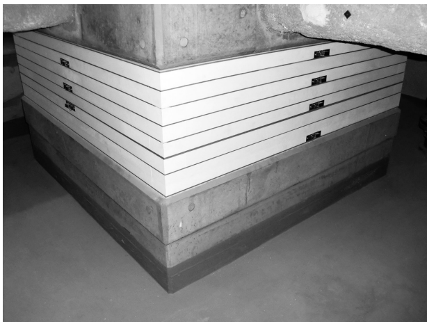
写真4 中間階免震層に設置された角型鉛プラグ入り積層ゴム (写真提供：株式会社竹中工務店)
