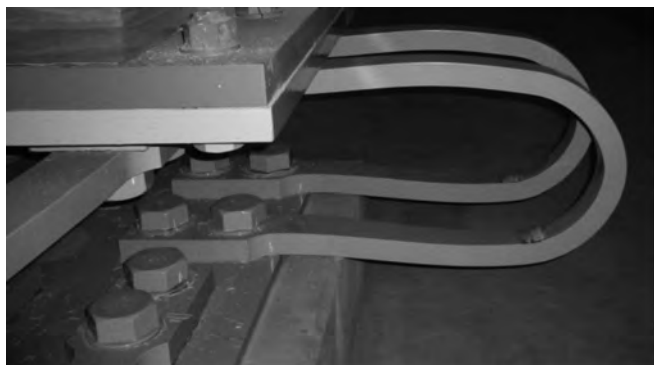
東北地方太平洋沖地震を経験した免震U型ダンパー (建物：石巻赤十字病院、撮影：新日鉄住金エンジニアリング)
