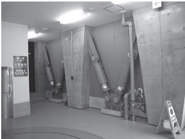
図15 建物Nの制振ダンパー
