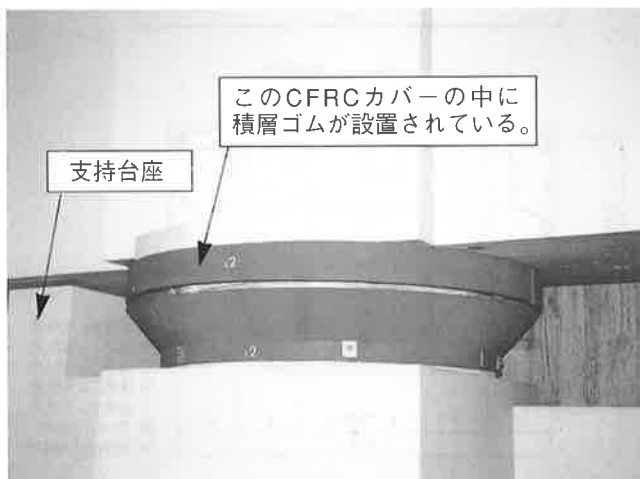
写真-3 積層ゴム
