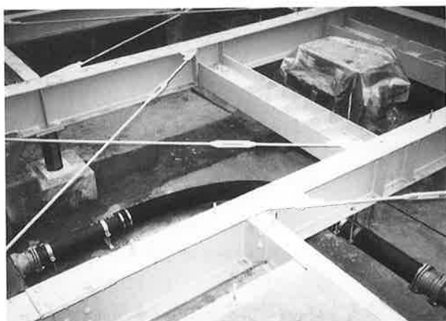
写真-5 配管フレキシブルジョイント
