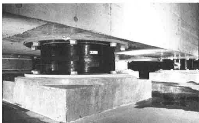
写真-12 基礎に設置された積層ゴム
