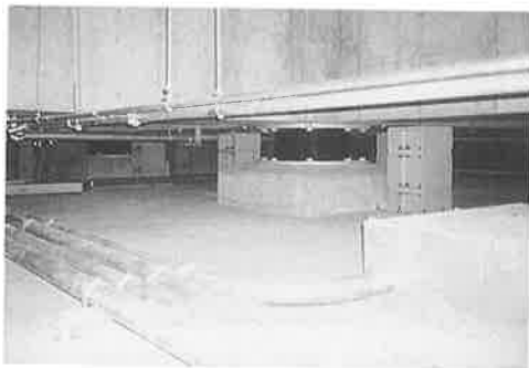
写真-4 免震装置
