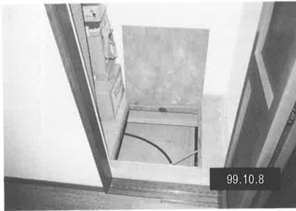
写真-4 免震層点検用ハッチ
