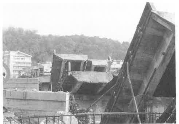
写真一30・31 台中県大平市一江橋の被害 PC桁の落橋だけでなくピアから5～6mのずれを生じている。
