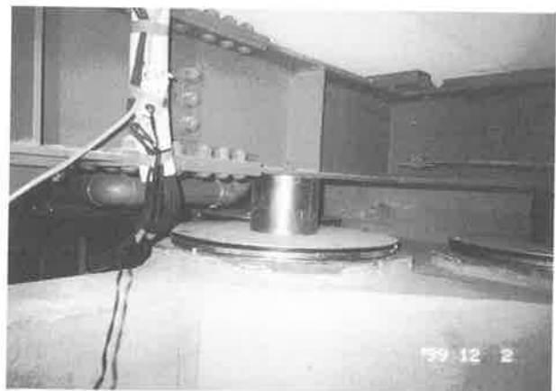
写真-2 ベアリング支承
