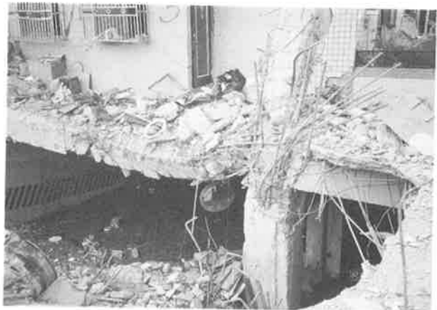
写真一35 右側に傾斜建物の地階柱の破壊
