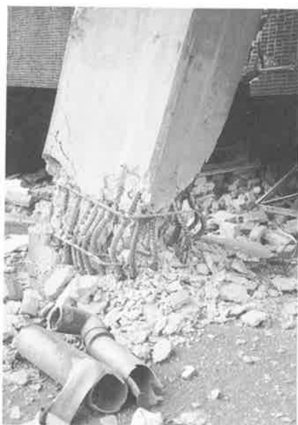
写真一12 柱脚部柱筋の座屈
