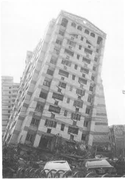
写真一26 台中県大平市 S集合住宅、1997年竣工地上14階地下1階、地下駐車場、1階店舗、上部集合住宅。地下部分および1階が崩壊している。
