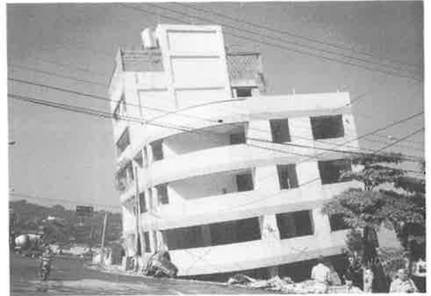
写真一18 台中県東勢 RC6階 1階部分の柱破壊、1階角の柱が抜けているため偏心している
