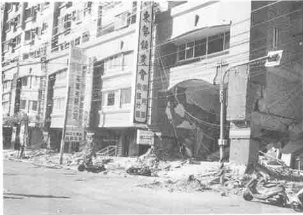
写真一15 G集合住宅1階部分の柱のほとんどが破壊している
