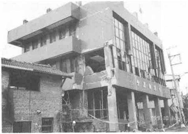
写真一4 南投県中寮 中寮郷農會RC 3階1992年竣工 2階部分でねじり破壊している
