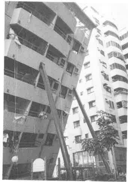
写真一34 傾斜した建物の裏側、控え鉄骨による応急処置
