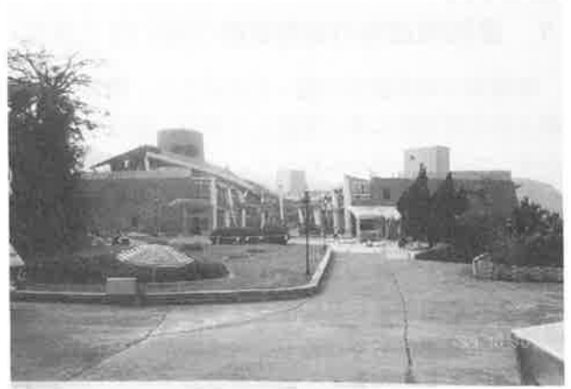
写真一7 南投県日月潭 教師会館RC 3階建て、中央部 の崩壊
