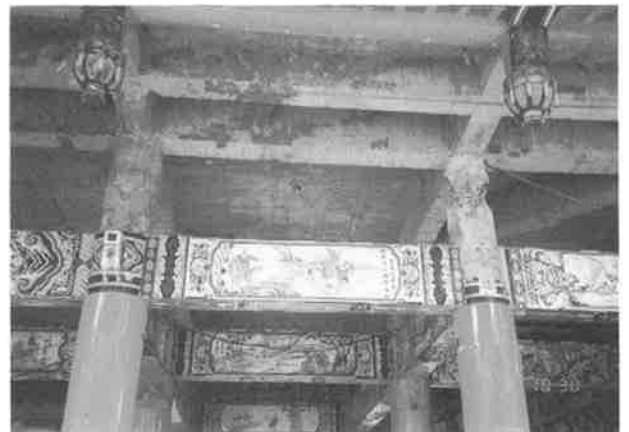
写真一9 中門1階中頭のせん断破壊
