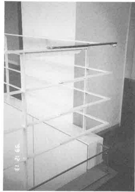
写真-8 連絡通路の免震用手摺
