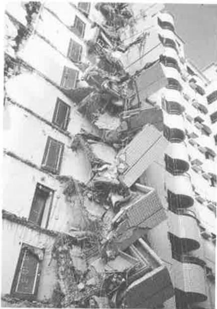
写真一33 左側の被害の様子
