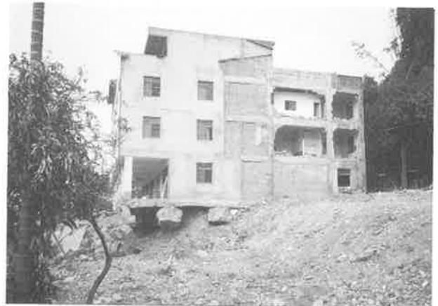
写真一25 石岡ダム周辺 隆基礎部分が露出した。
