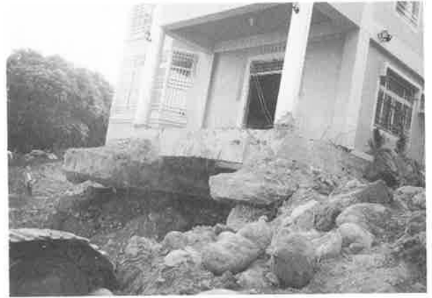
写真一29 台中県大平市 一江橋付近の建物、断層隆起により基礎が露出し建物も傾斜している。(再使用を予定しているとのこと)
