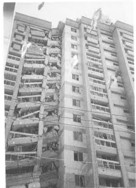
写真一42 Tビル 2棟を繋いだ境界部分1階柱破壊により梁が傾斜している
