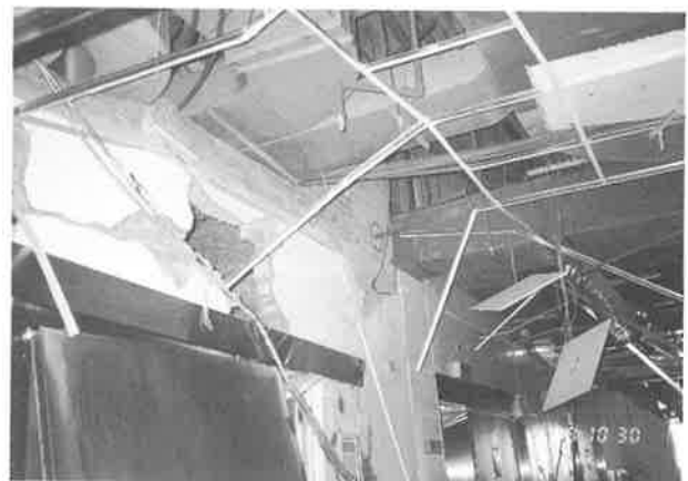
写真三 T病院内部間仕切り煉瓦の崩落、設備系統、天井の被害が見られる
