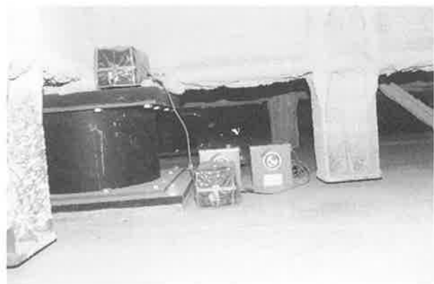
地下1階の床下の免震装置と地震の記録計
