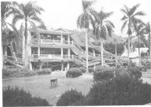
写真一37 台中県霧嶺 光復國小中学校 断層上の校舎、崩壊した。断層は右側に続いている
