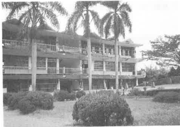
写真一38 光復國小中学校 断層からはずれている校舎、崩壊には至っていないが、柱の破壊が大きい
