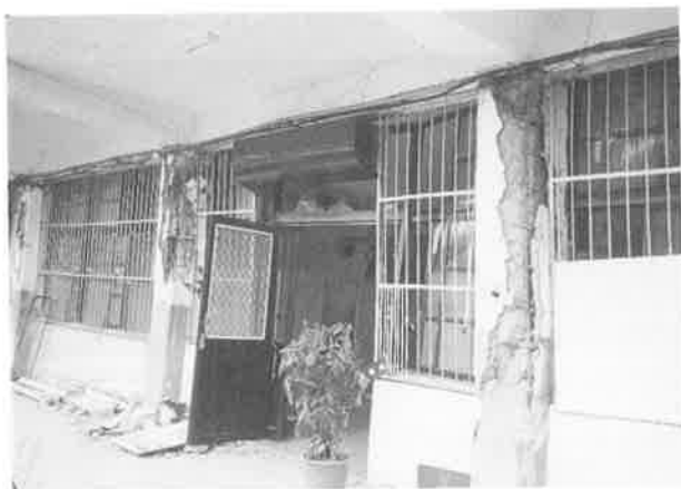
写真一39 光復國小中学校 柱の破壊の様子
