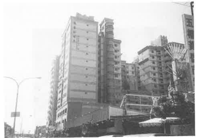
写真一41 台中省轄市 Tビル、1階店舗上階共同住宅、RC14階地下2階1階柱の破壊が顕著である
