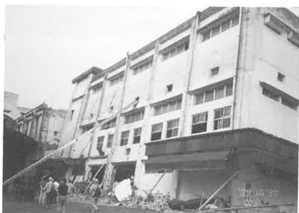
写真一11 南投県埔里 紹興酒工場RC3階築25年 1階柱せん断破壊
