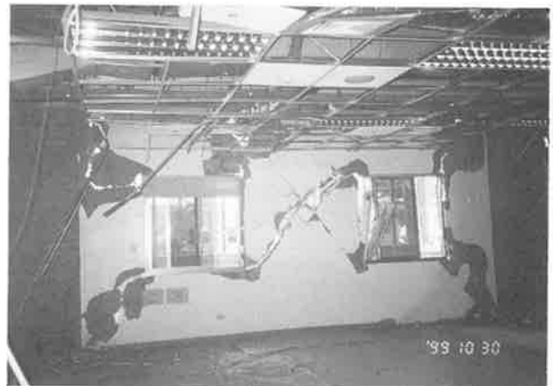
写真二 T病院内部開口壁のせん断破壊
