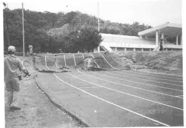
写真一40 光復國小中学校隣のグラウンド トラックに約1.5mの段差ができた、向こう側の建物は目立った被害は見られない
