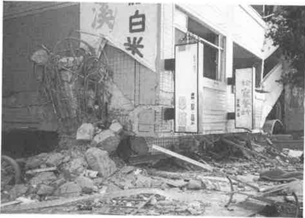
写真—43 Tビル 1階柱の破壊、鉄筋の座屈が見られる
