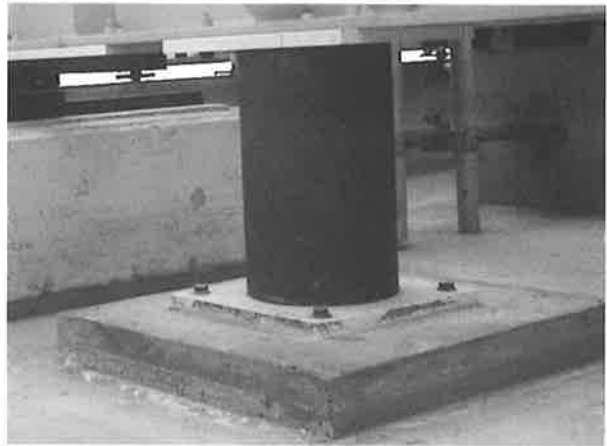
写真二 復元・減衰装置HDR設置例
