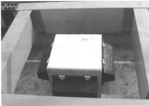
写真-5 変形制限装置例
