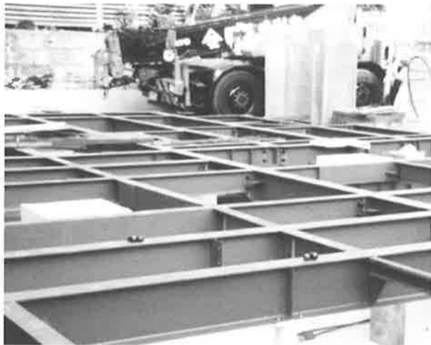
写真-7 免震フレーム例
