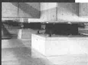
免震装置設置状況 LRB (φ1200)
