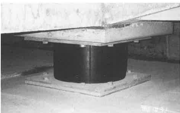
写真2 積層ゴム支承
