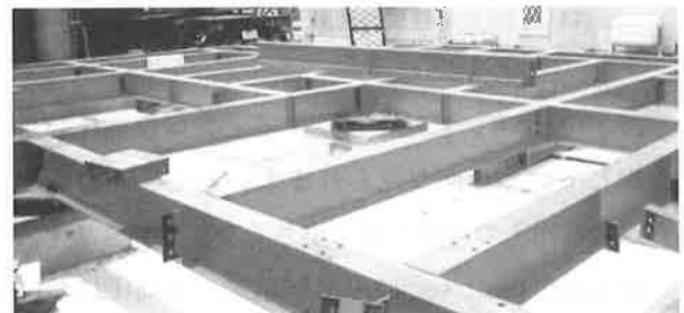
写真-2 鉄骨架台写真
