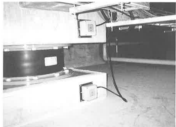
写真-5 加速度ピックアップ装置
