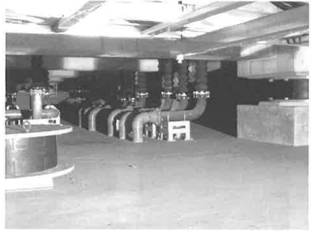
写真-5 設備配管の様子
