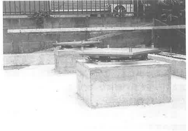
写真-12 設置後の免震装置
