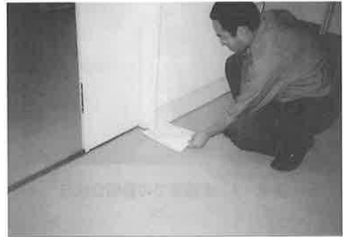
写真-10 階段室壁の2階床直上スリット
