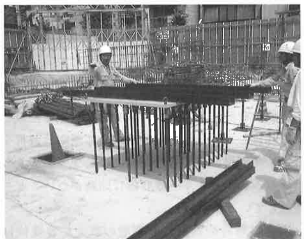
直動転がり支承の下部定着鉄筋
