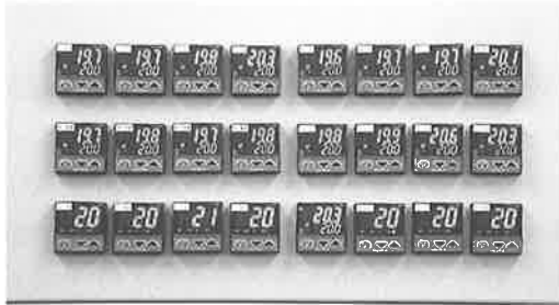
写真-4 温度管理システムの監視・調整盤
