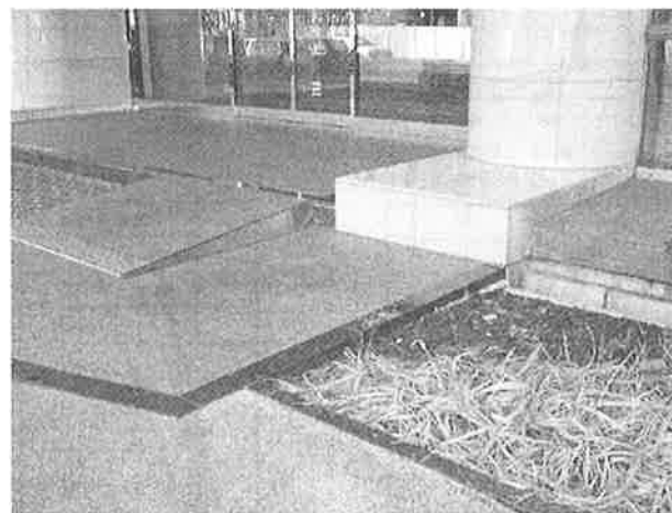
写真-10 エントランスEXP.J部分
