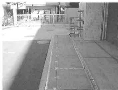
写真二 エキスパンションジョイント設置状況
