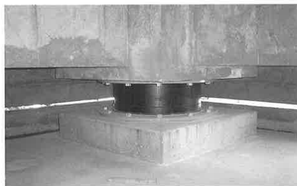
写真一三 免震装置及びスリット状況(耐火スリット未設置)
