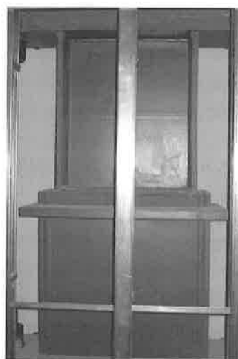
写真-4 制震間柱(軽鉄越しに撮影)
