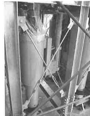
写真-2 制震装置HiDAM（オイルダンパー）
