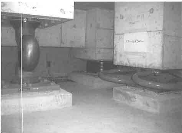
写真10 G建物の免震部材
