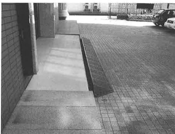
写真3 移動した段差スロープ
