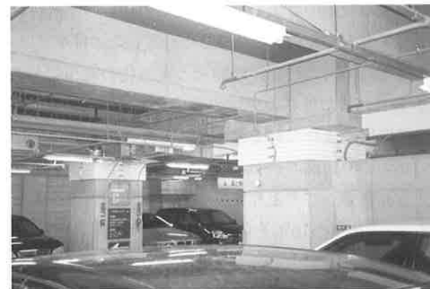
写真-7 地下駐車場の柱頭部状況 (平成17年3月撮影)
