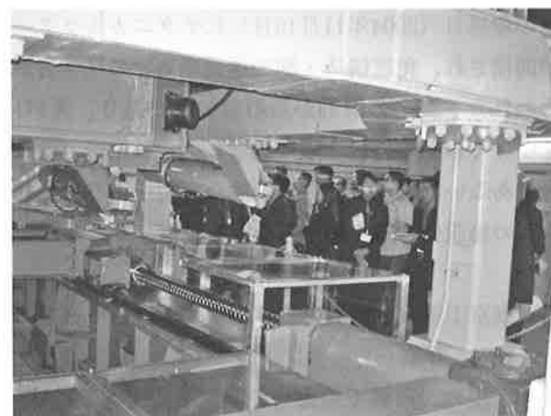
写真-5 横浜ランドマークタワー制振装置
