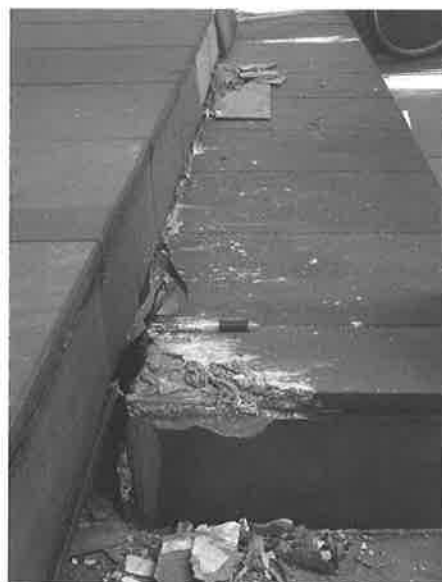
写真4 C建物の玄関周辺の損傷
